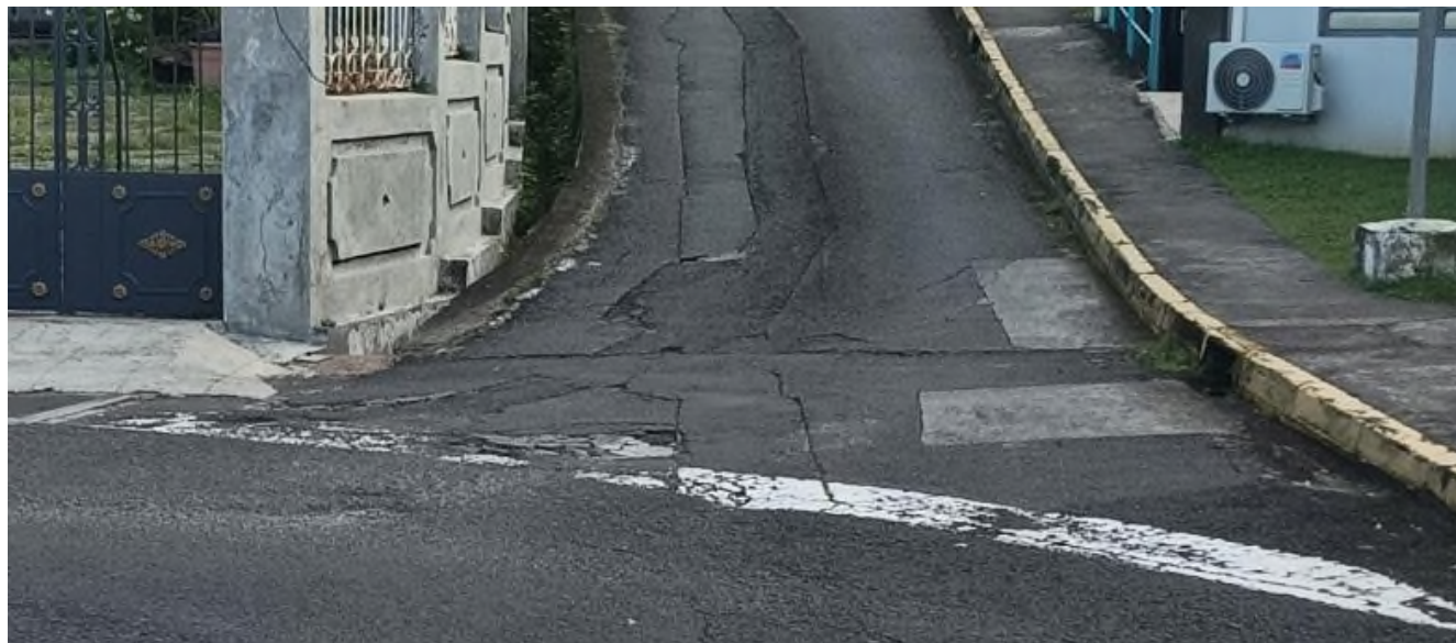
Figure 12 : Réparations diverses + fissuration + arrachement (ornière)
