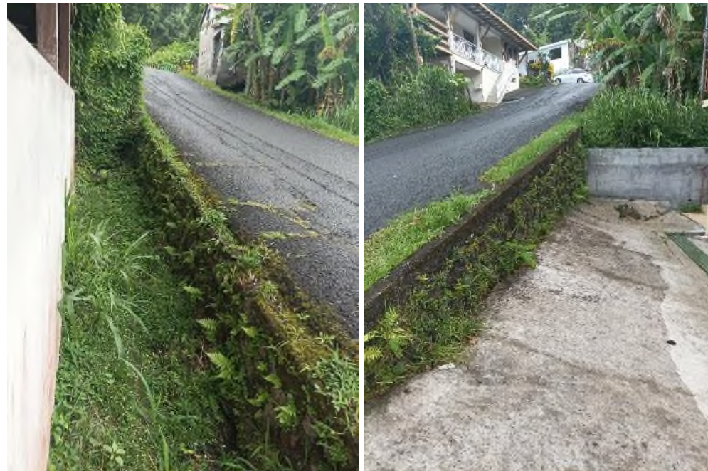
Figure 21 : Murs de soutènement non-équipés de garde-corps
