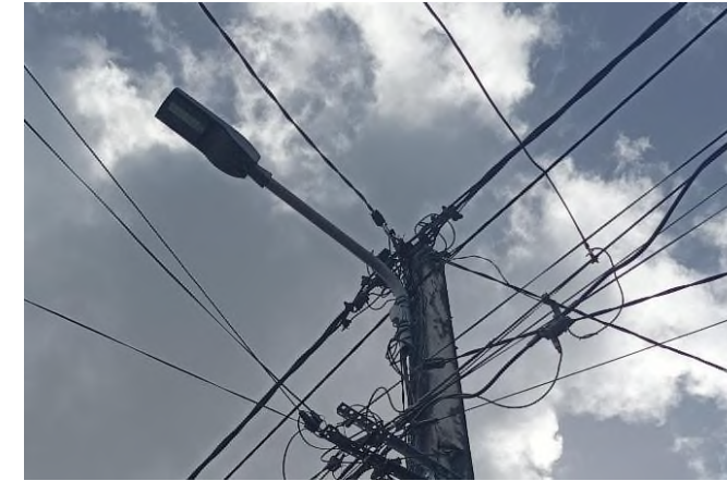
Figure 32 : Luminaire récents existants sur support commun
