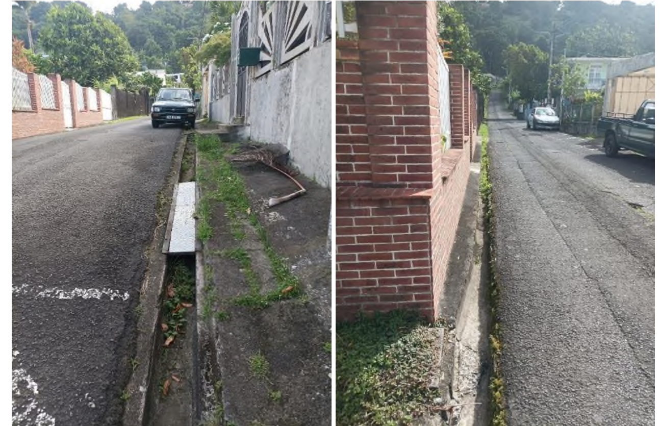
Figure 27 : Caniveaux à ciel ouvert état moyen
