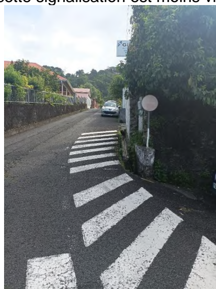
Figure 19 : Panneau « sens interdit » vétuste – Signalisation horizontale type zébras
