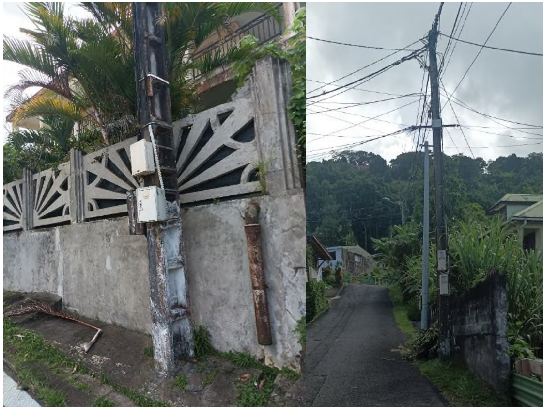
Figure 34 : Coffrets sur supports communs
