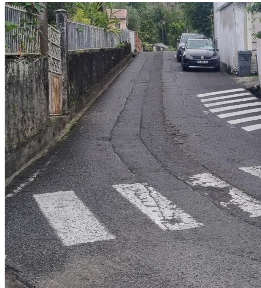
Figure 10 : Fissurations du revêtement et début d'ornières
