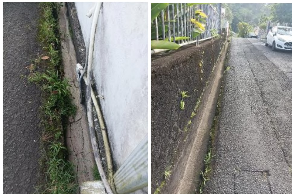
Figure 26 : Caniveaux à ciel ouvert dégradé et état moyen
