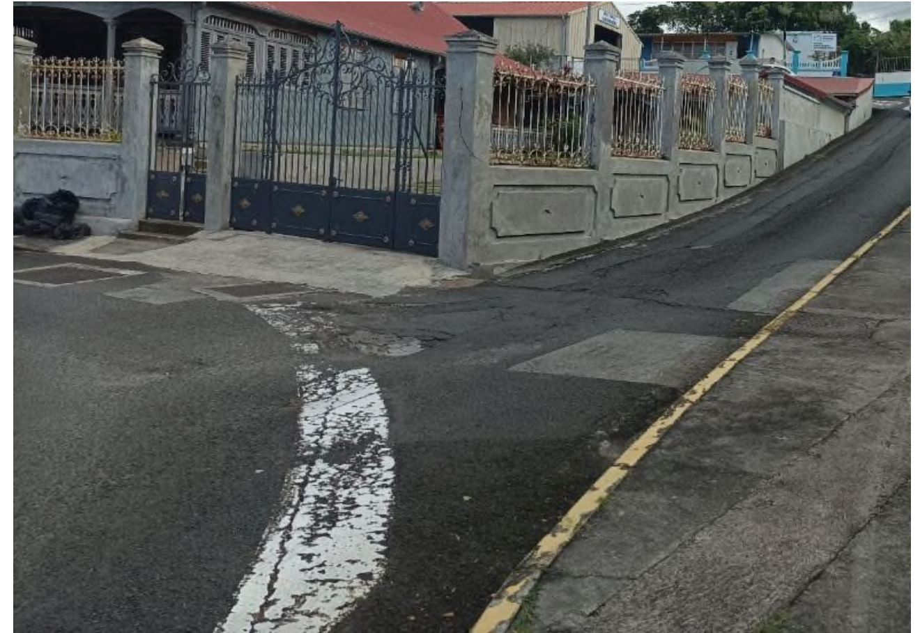
Figure 13 : Réparations diverses + fissuration + arrachement (ornière)
