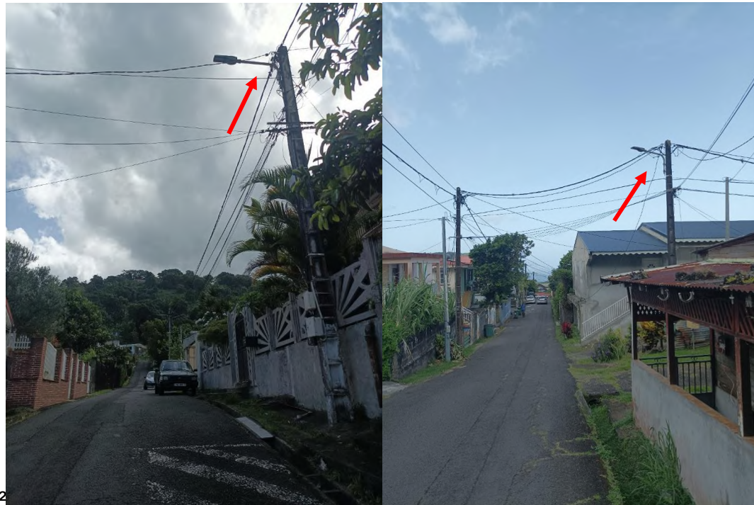
Figure 31 : Luminaires sur support commun
