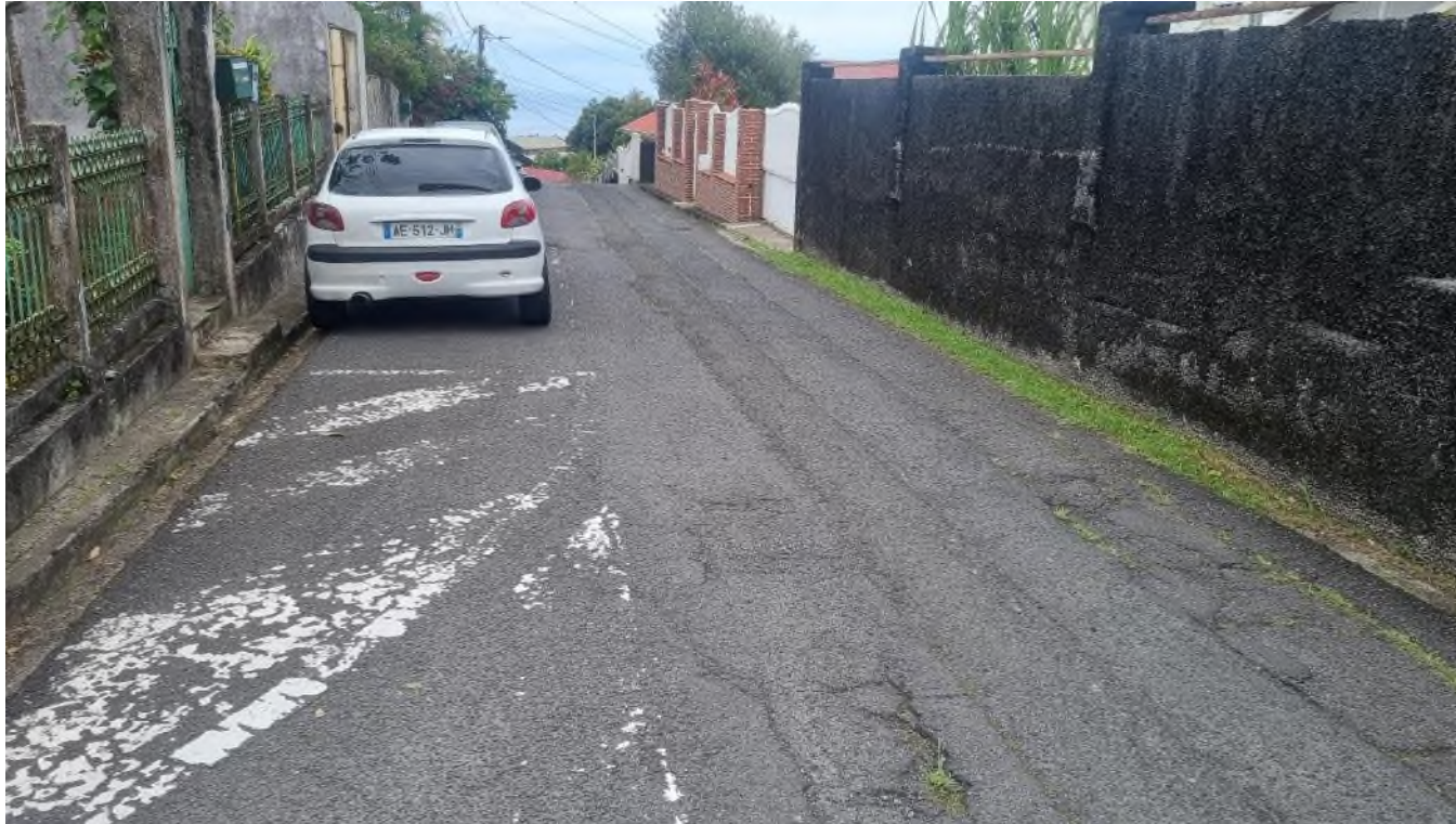
Figure 11 : Fissures observées dans les joints de reprise le long des tranchées + début d'ornières
