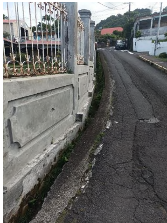
Figure 22 : Mur de soutènement non-équipé de garde-corps
