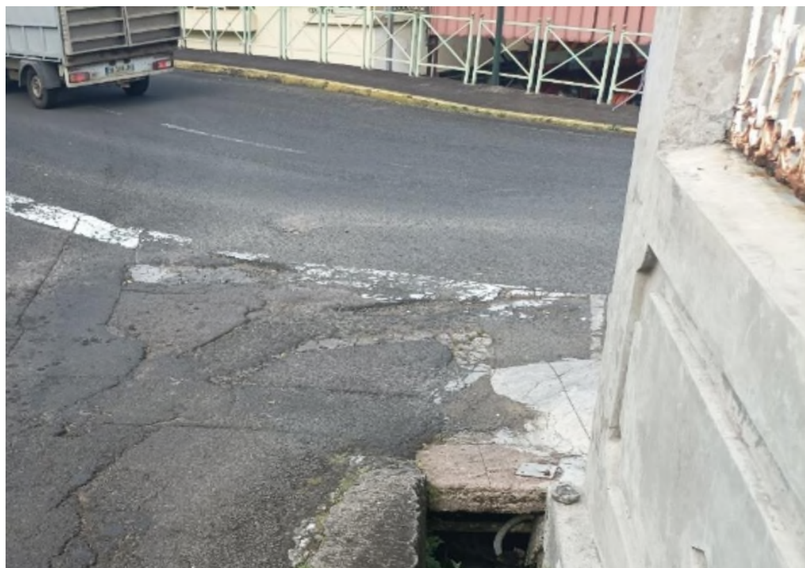
Figure 9 : Arrachement du revêtement + fissures
