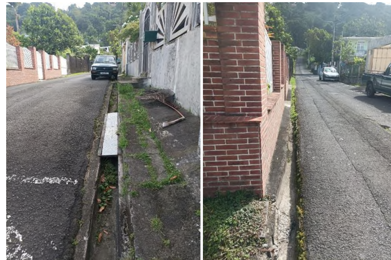
Figure 27 : Caniveaux à ciel ouvert état moyen
