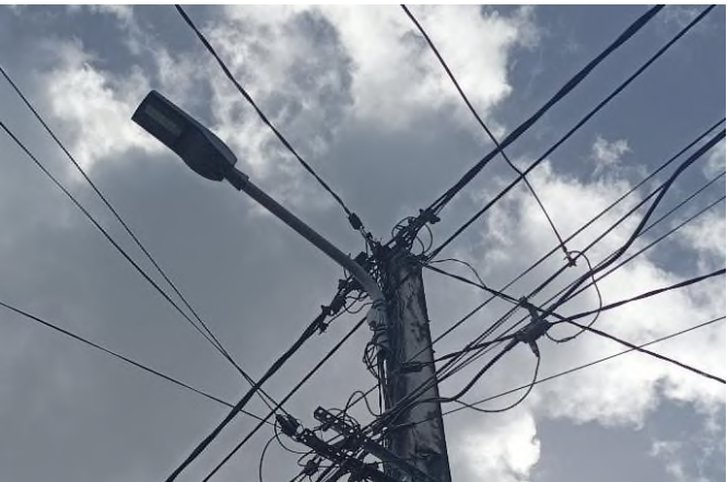
Figure 32 : Luminaire récents existants sur support commun
