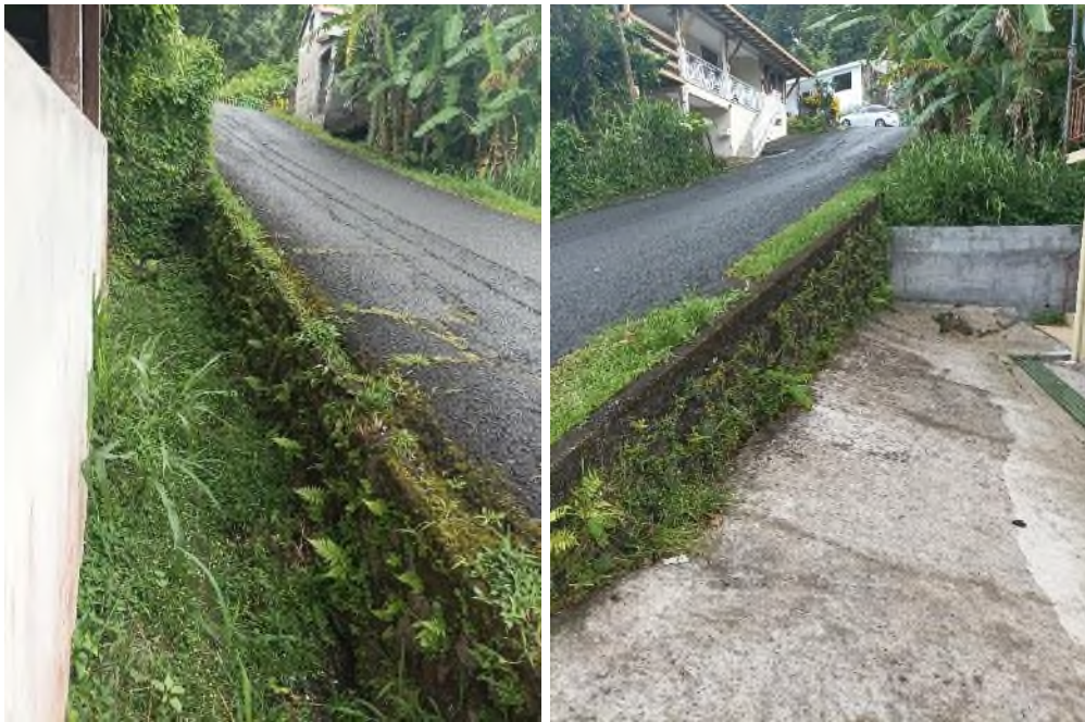
Figure 21 : Murs de soutènement non-équipés de garde-corps
