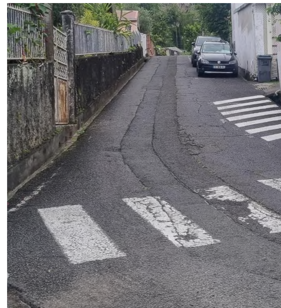
Figure 10 : Fissurations du revêtement et début d'ornières
