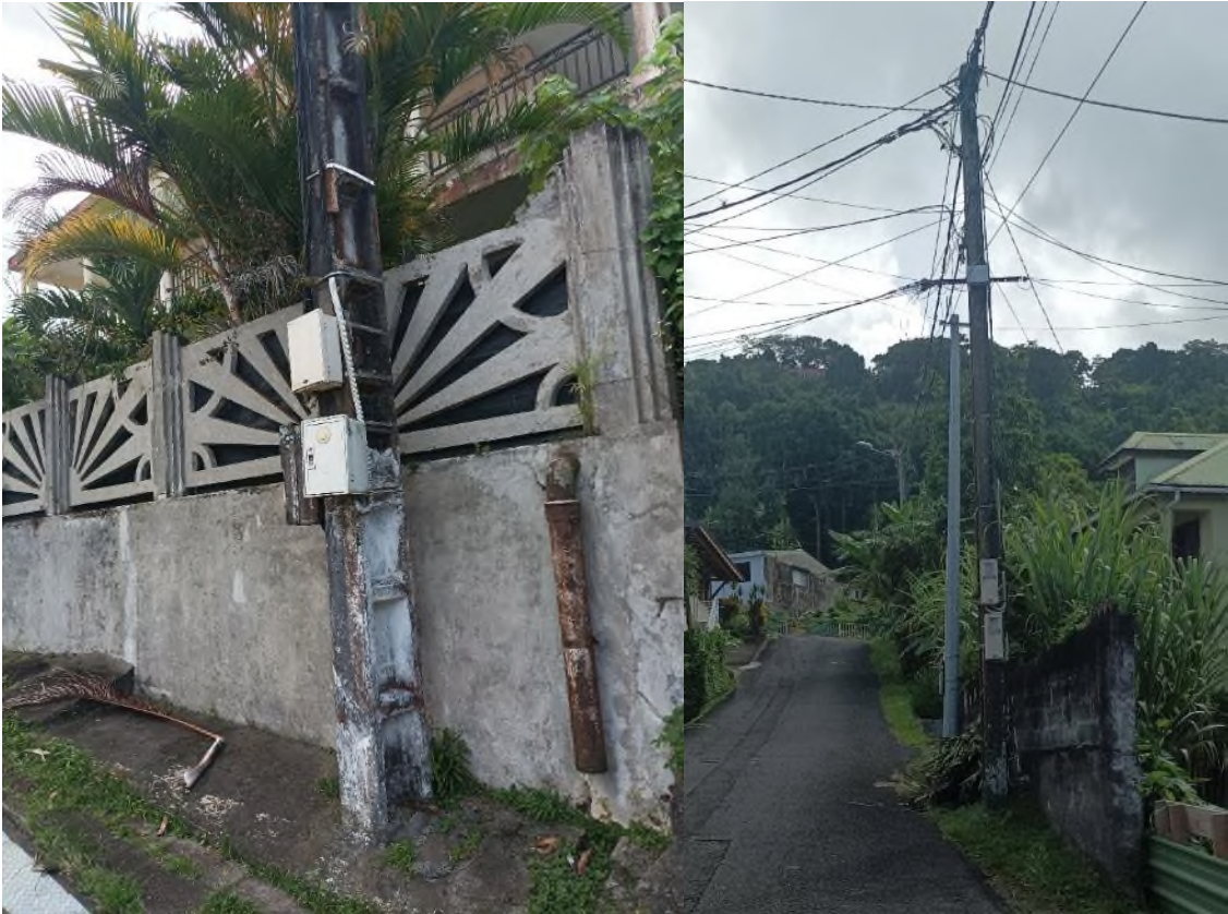
Figure 34 : Coffrets sur supports communs
