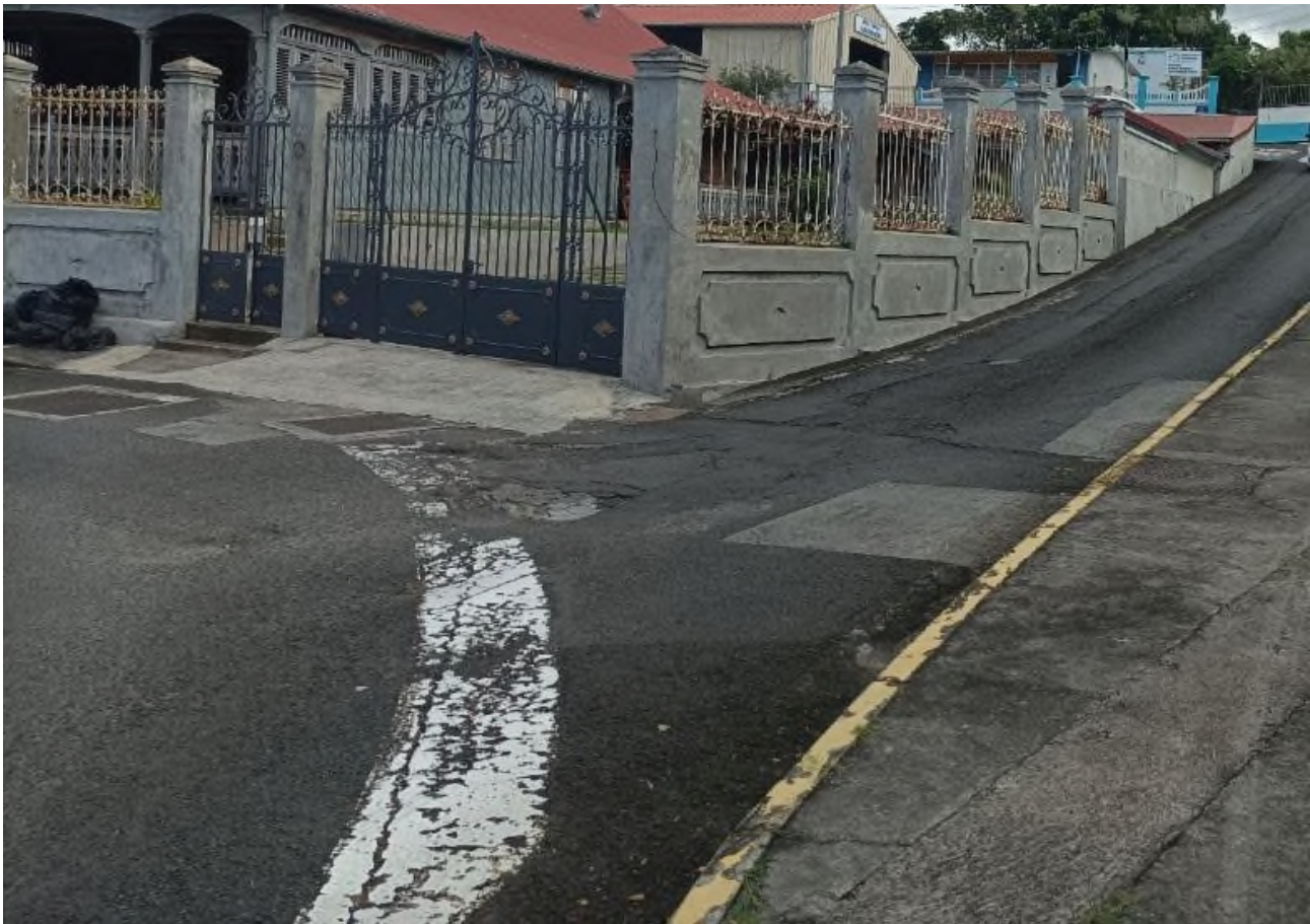
Figure 13 : Réparations diverses + fissuration + arrachement (ornière)
