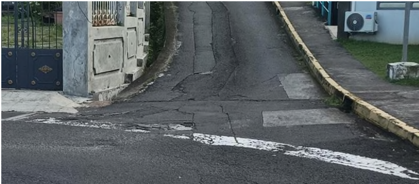
Figure 12 : Réparations diverses + fissuration + arrachement (ornière)
