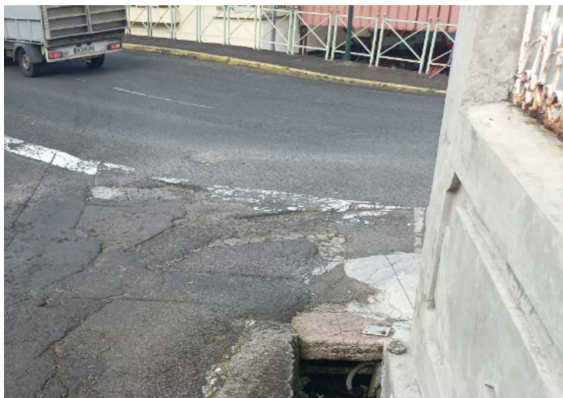
Figure 9 : Arrachement du revêtement + fissures
