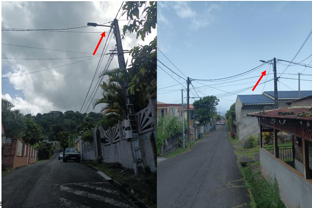
Figure 31 : Luminaires sur support commun
