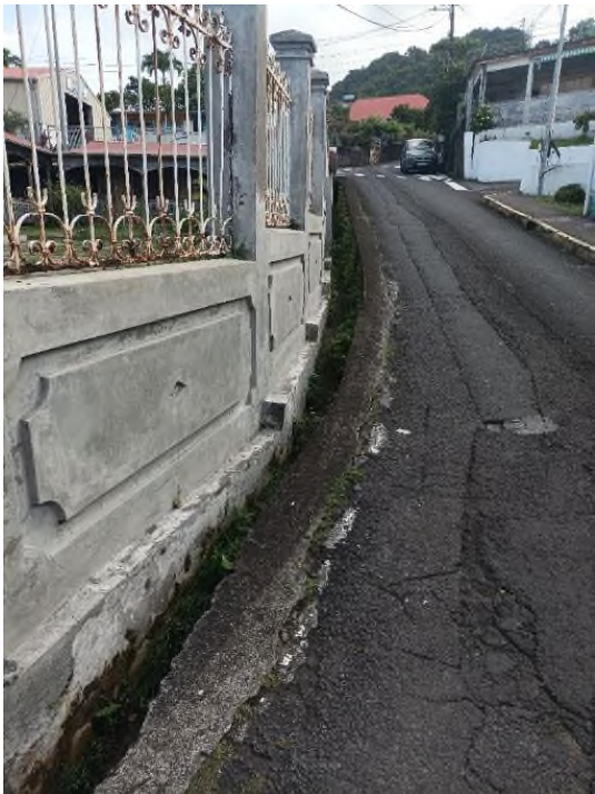
Figure 22 : Mur de soutènement non-équipé de garde-corps
